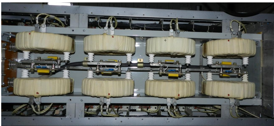
Рис. 8. Импульсные трансформаторы в стойке модулятора: 1 – выводы первичной обмотки; 2 – внешняя изоляция; 3 – высоковольтные выводы (выводы вторичной обмотки).
