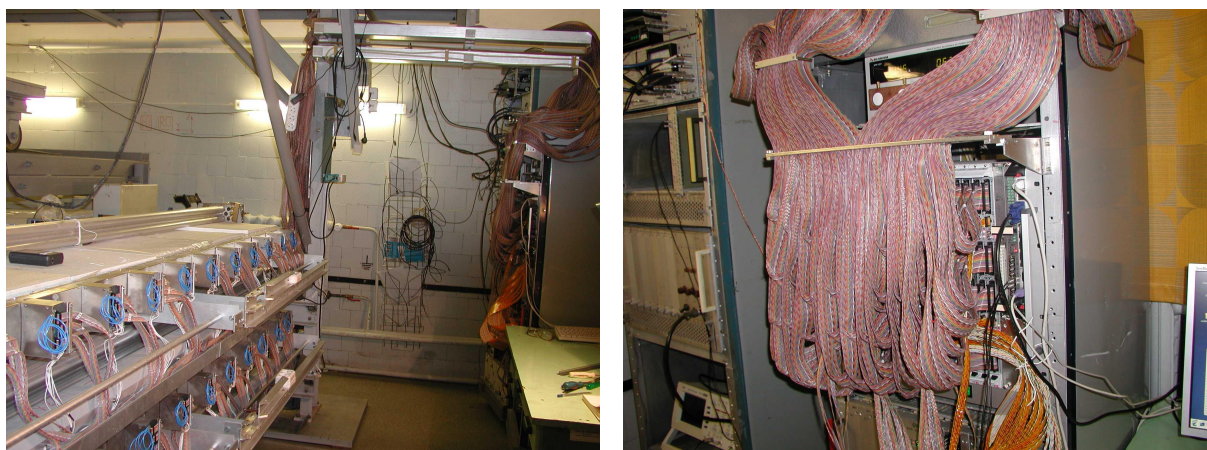
Рис. 2. Левая фотография демонстрирует усилители, подключенные к дрейфовым камерам и подключенные кабели к ним; правая фотография: подключение сигнальных кабелей к ВЦП
